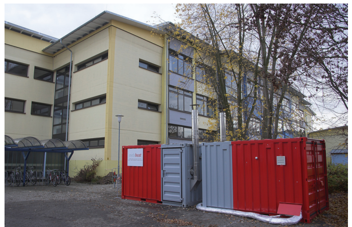
Mobile Nahwärmeversorgung: In Neustadt beheizen mobile Heizanlagen von mobiheat® eine Schule, ein Schwimmbad sowie eine Wohnanlage
