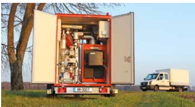
Eine voll funktionsfähige Heizzentrale mit 300 kW – kompakte Technik auf engstem Raum.
